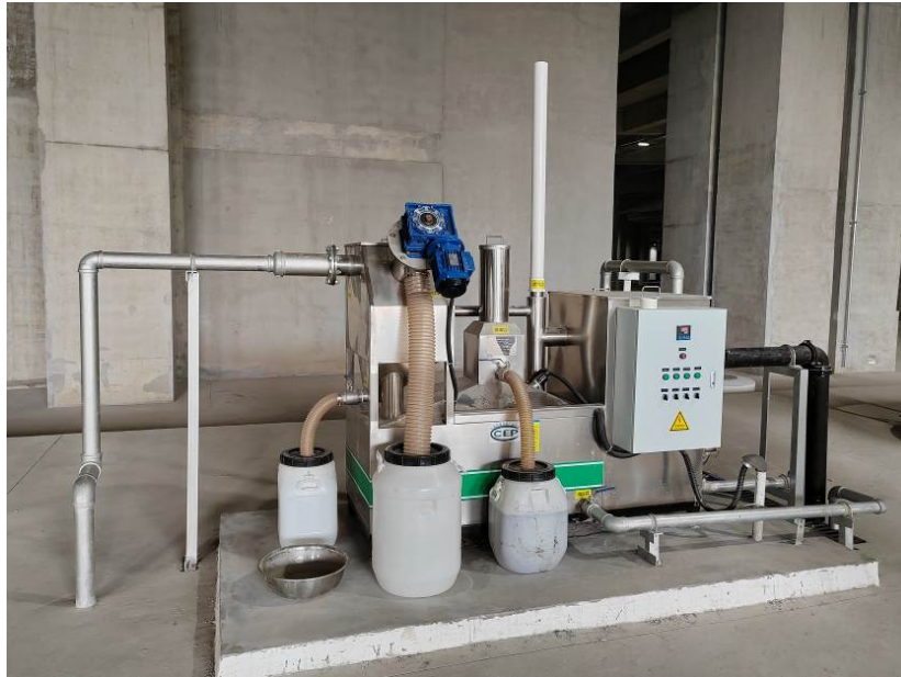
图9.1-2 幸福车辆段污水处理站照片
