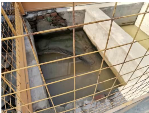
沉淀池淤积(整改前)2022.7
