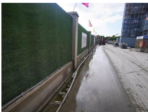
排水沟淤积(整改前)2022.9
