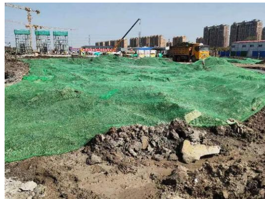
裸土已苫盖(整改后)2022.3
