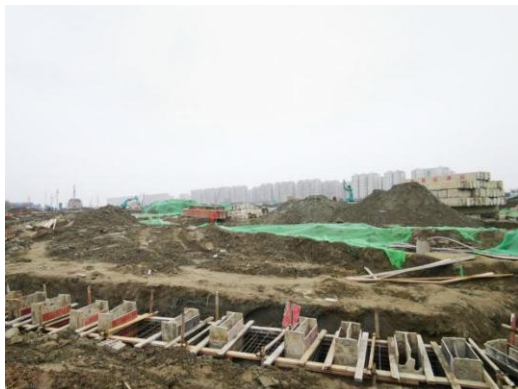
裸土苫盖不全(整改前)2022.1
