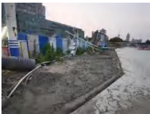
裸土未苫盖(整改前)2022.8
