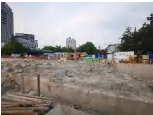
裸土未苫盖(整改前)2022.8
