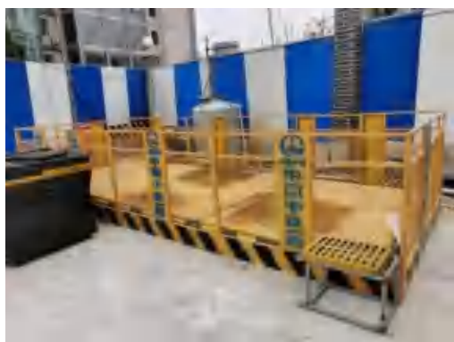
易家桥站三级沉淀池 2019.12
