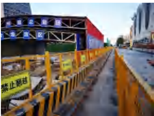
汽车东车站基坑四周排水沟 2020.9
