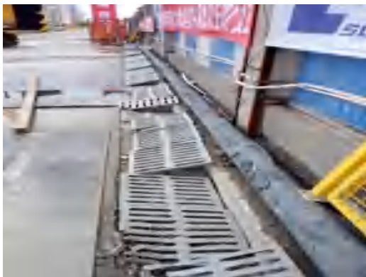
排水沟损坏、淤积(整改前)2020.4
