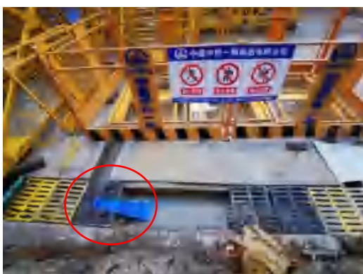
排水沟与沉淀池衔接不合理(整改前)2021.2
