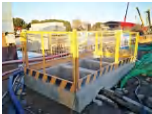
幸福车辆段三级沉淀池 2021.12
