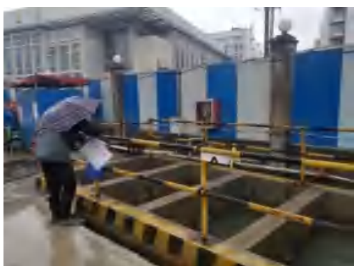
(107)五一路站三级沉淀池 2020.1
