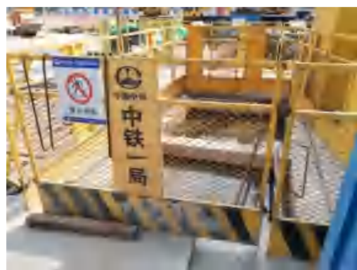
(98)易家桥站三级沉淀池 2021.6
